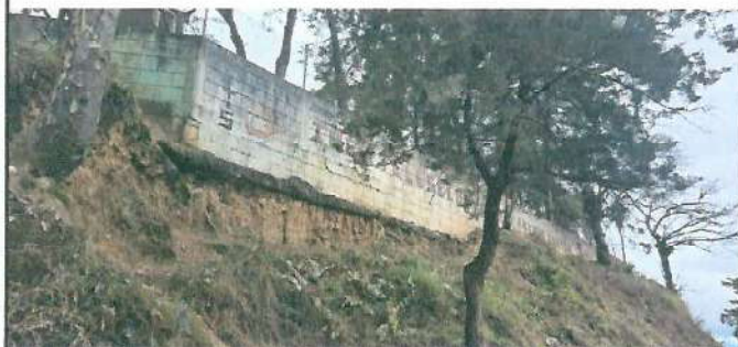
Foto 1: Vista exterior del muro de contención con evidente socavamiento debido a la erosión de la tierra.
