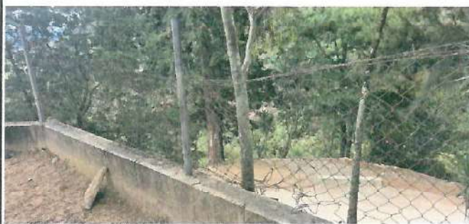
Foto 2: Deterioro de la malla, misma que forma parte del muro de contención.
